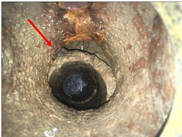
Foto 1: Rotte stikker snuden frem i et knækket kloakrør
